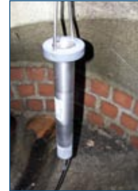
MODUL autark eingehängt im Abwasserschacht
