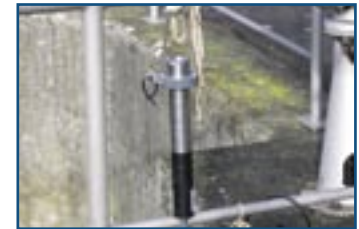
MODUL autark Messung Zulauf Kläranlage
